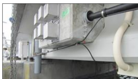
定着体付近配線状況
