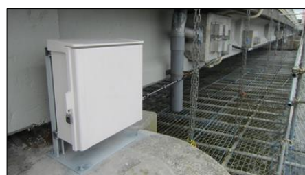
信号ケーブル存置状況
