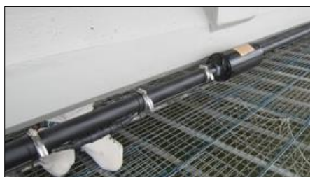
EMセンサー付近配線状況
