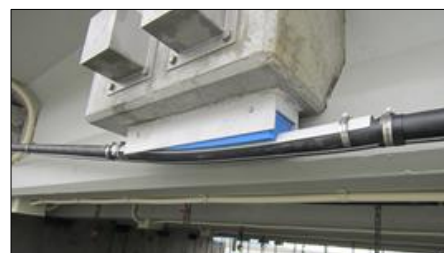
偏向部付近配線状況
