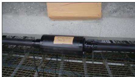
EMセンサー固定状況
